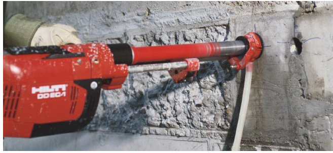
Figura 16 – Perforazione a corona diamantata in umido con un trapano portatile Hilti con tecnologia a cattura dell'acqua.
