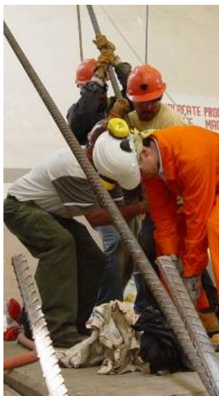
Figura 26 – L'installazione di un ferro lungo nel foro riempito di resina può richiedere l'intervento di diversi operatori.
