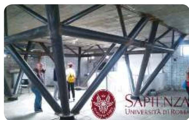
Torre civica di Rieti: soluzione con Tuned Mass Damper non convenzionali basati su ricerche DISG
