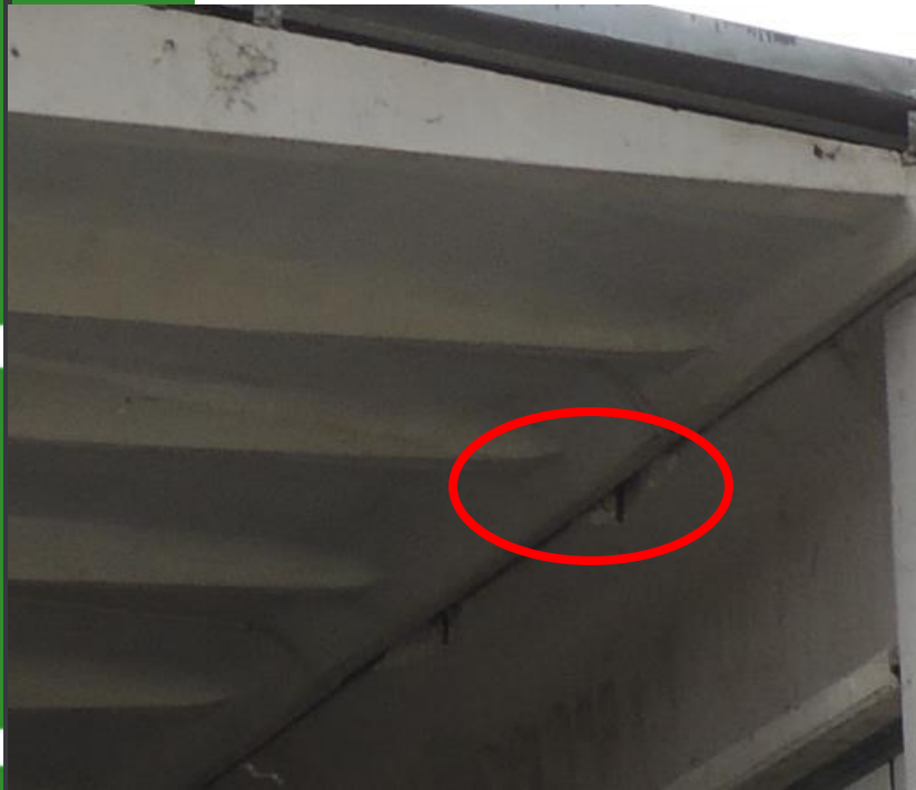
Edificio a Norcia Danni terremoto 2016
